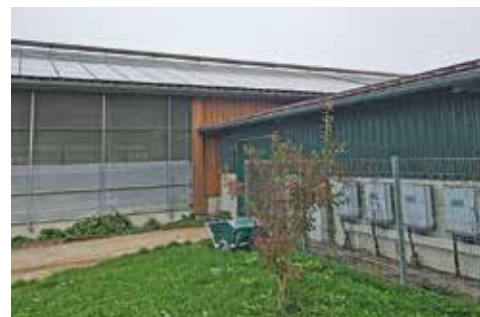
Die Wechselrichter für den PV-Strom
