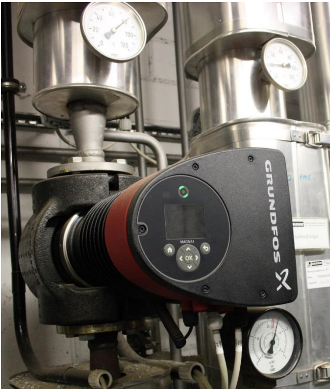
Abbildung 4: Eine der modernen geregelten und damit energiesparenden Umwälzpumpen
