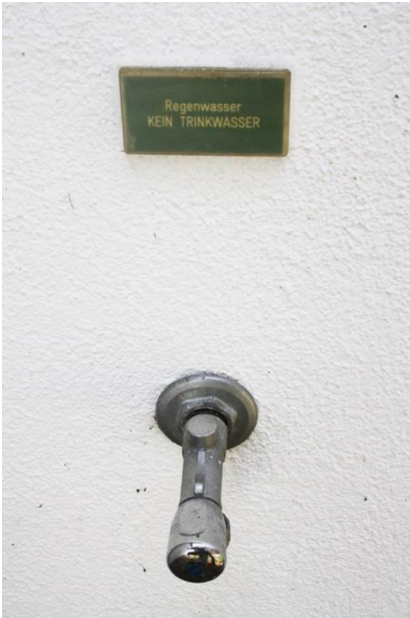
Abbildung 7: Brauchwasserhahn zur Gartenbewässerung
