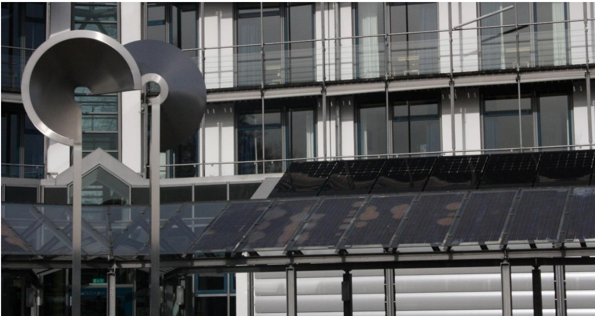
Abbildung 3: Die Photovoltaikmodule auf den Kolonnaden (vorne, außer Betrieb) und als Verschattungselemente (hinten, neu)
