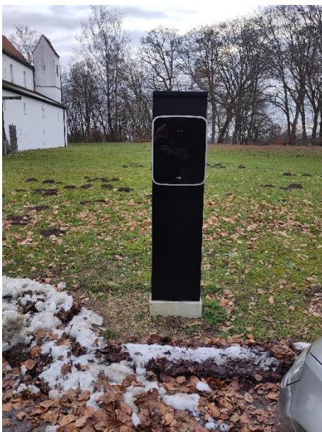
Abbildung 5: Ladestation für Elektromobile
