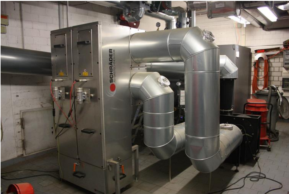
Abbildung 2: Hackschnitzelkessel mit Hochvoltageabscheider für Feinstaub 1
